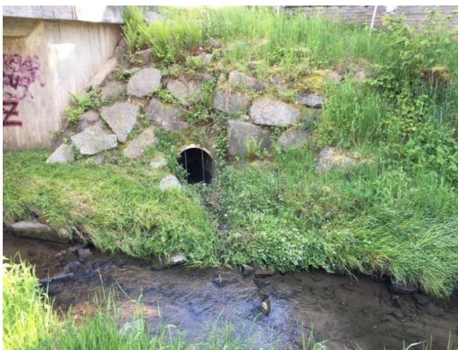
Abbildung 2: Einleitestelle in den Hensbach
