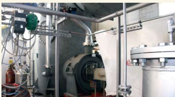
Turbine und Generator
