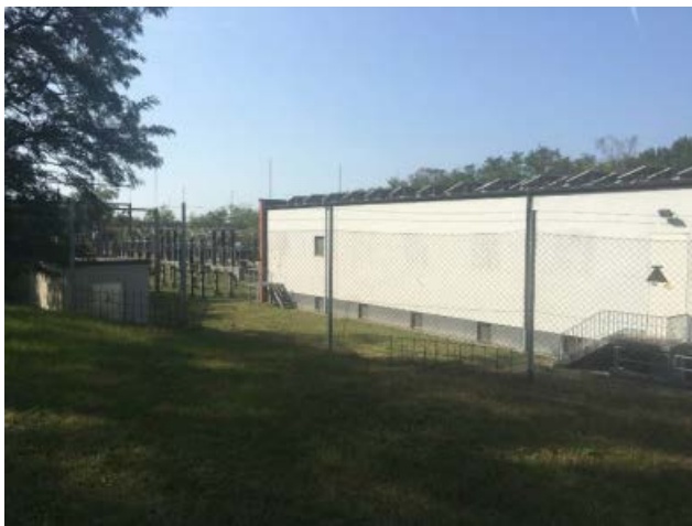
Abbildung 86: Umspannanlage in Aschaffenburg. Eigene Aufnahme GreenAdapt 2020.
