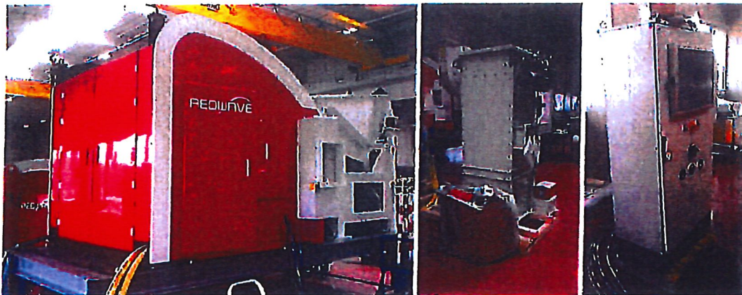
Links: REDWAVE Sortiermaschine und Vibrationsförderrinne auf Stahlrahmen; Mitte: Ansaugventilator; Rechts: Schaltschrank
