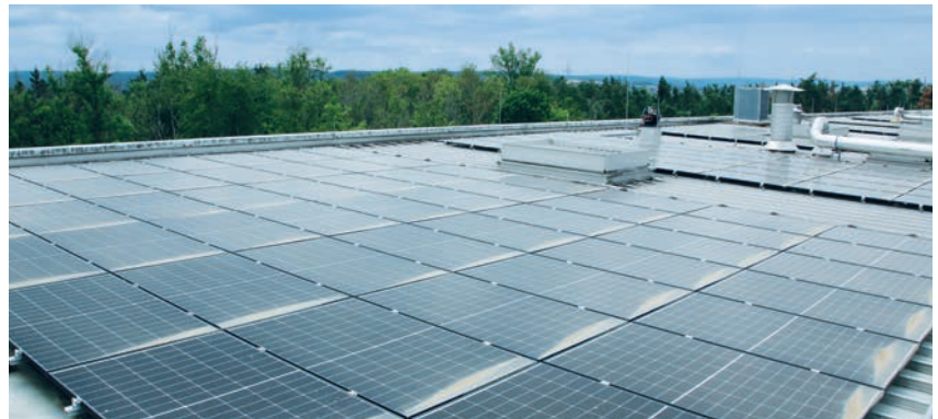
PV-Anlage mit 300 kW auf dem Dach des Wasserwerks
